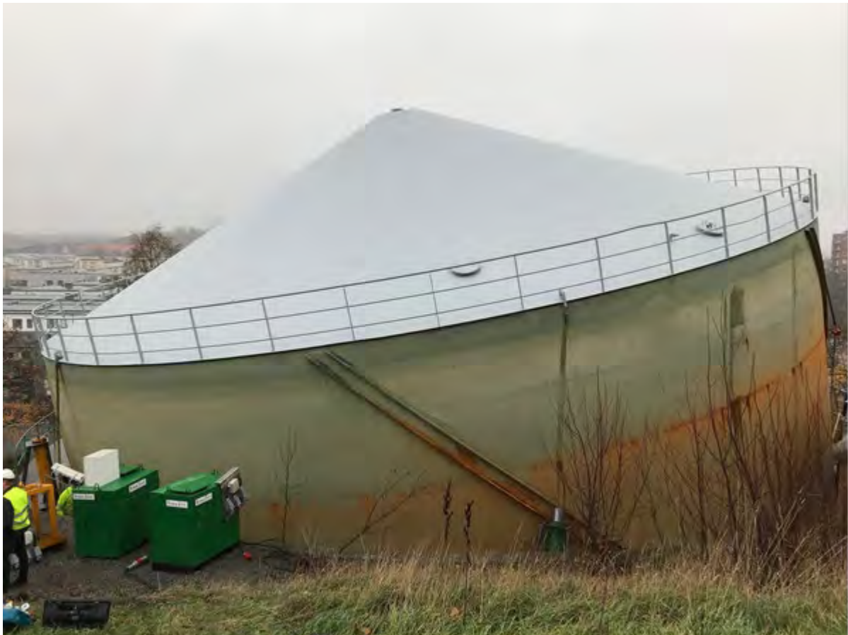
Figur 8: Gasklockan havererade i november vid ett lyft för underhåll.
